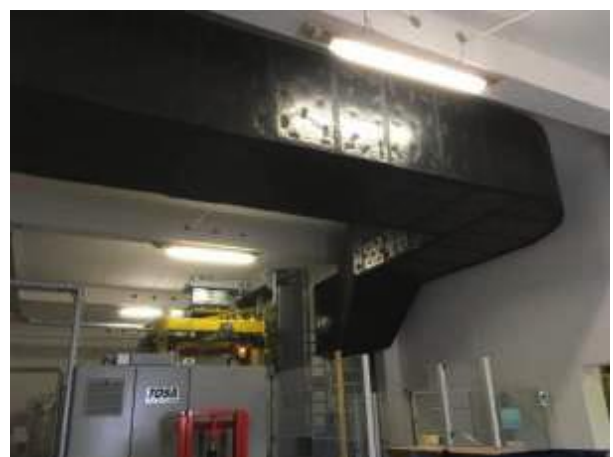
Bekleideter Luftkanal mit einer Brandschutzplatte aus Mineralwolle
