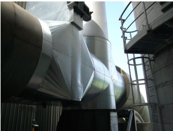
Motorrauchgasklappe in einem Zementwerk
