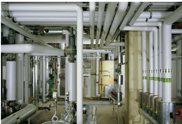
Heizzentrale einer Wohnanlage - Dämmung mit PVC - Mantel
