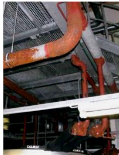
Abbildung 6: Korrosion an Kälte­leitungen
