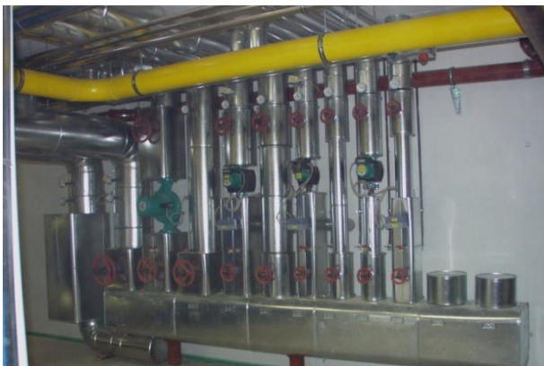
Heizungsverteiler im Keller eines Verwaltungsgebäude
