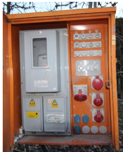
Baustromverteilerkasten mit FI
