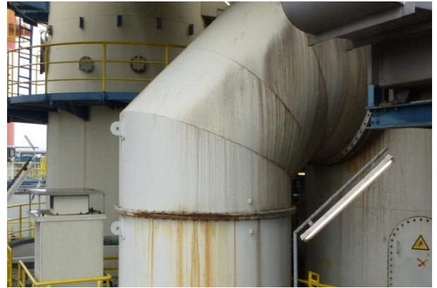
Fehlerhafter Korrosionsschutz an einem Flansch
