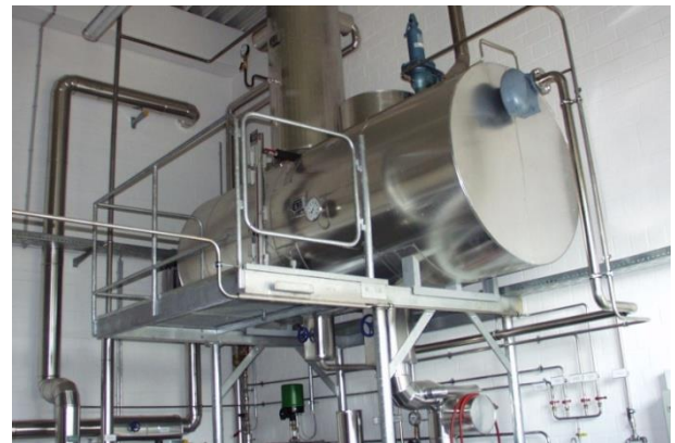
Warmwasserspeicher in einer Essenzen-Fabrik
