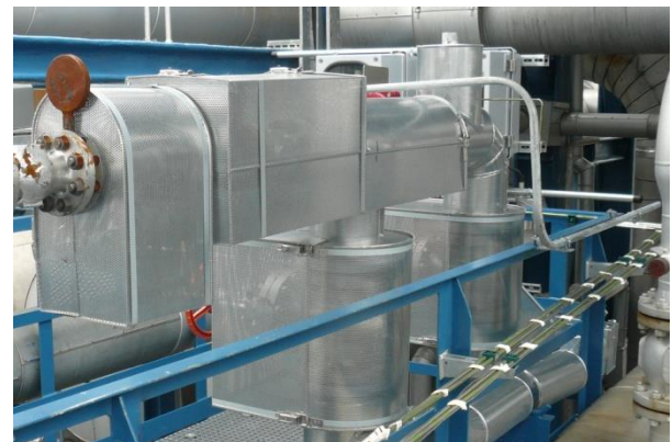
Berührungsschutz aus Lochblech in einer Raffinerie
