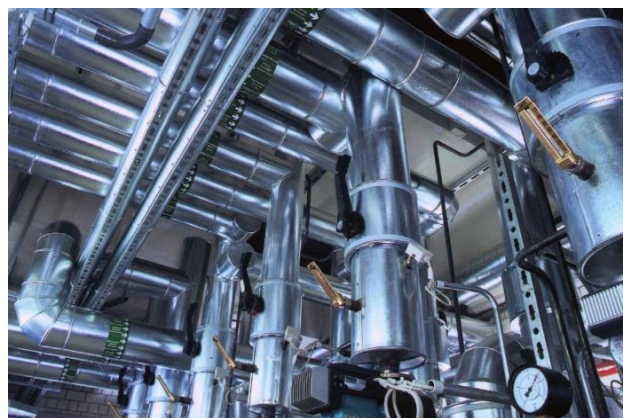
Kesselraum in einem Verwaltungsgebäude - Dämmung mit Blechmantel
