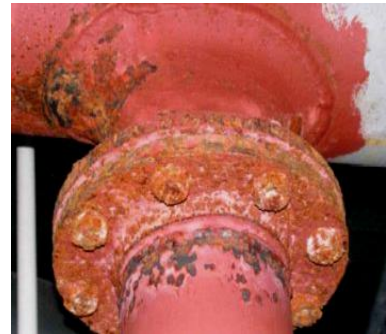
Abbildung 5: Korrosion an Flansch
