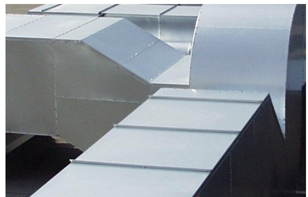
Stehfalz an einem Lüftungskanal im Außenbereich
