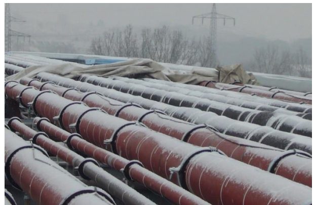
Kälteleitung mit Begleitheizung 2 x 19 mm Kautschuk mit verzinktem Blechmantel
