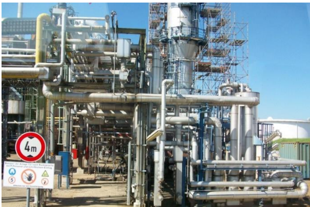
Anlage in der chemischen Industrie in mit Abgasen belasteter Atmosphäre
