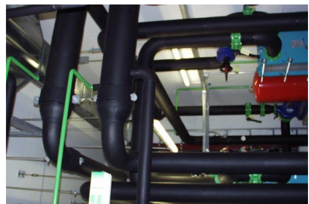
Kaltwasserleitungen mit flexiblen Elastomerschaum (FEF) gedämmt zur Tauwasserverhinderung
