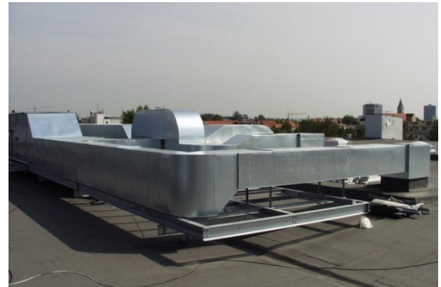
Klimaanlage auf einem Einkaufszentrum am Stadtrand
