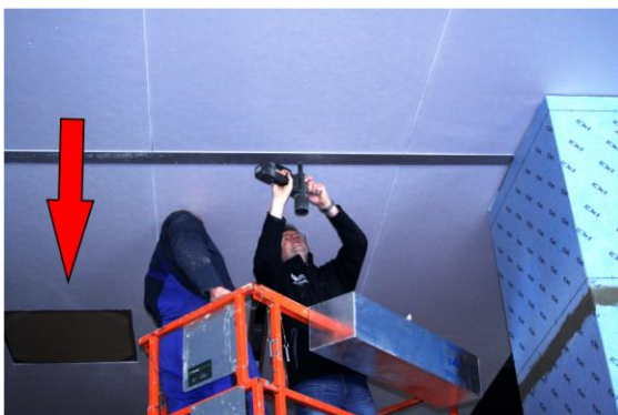
Bei großen Kühlräumen müssen Revisionsöffnungen für die Haustechnik vorhanden sein.
