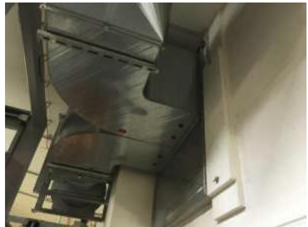
Unbekleideter Luftkanal an einer Brandwand
